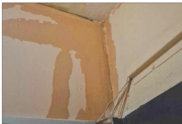
Стр. 4 – Отопление дали – подъезды затопило
