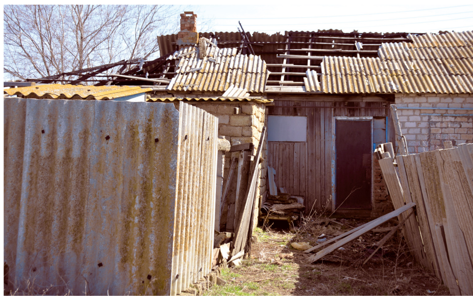
Одна из заброшенных квартир аварийного дома по ул. Шовканова
