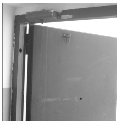
Отсутствует доводчик (пер. Строительный 2).
