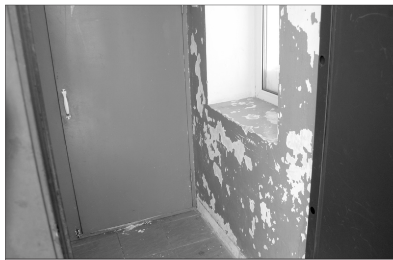
Входная дверь сломана и все время нараспашку, краска на стенах осыпается (пер. Строительный 2).
