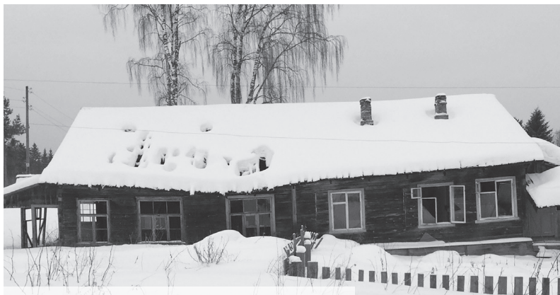
Власти отказываются признавать этот дом в Приречном аварийным.
