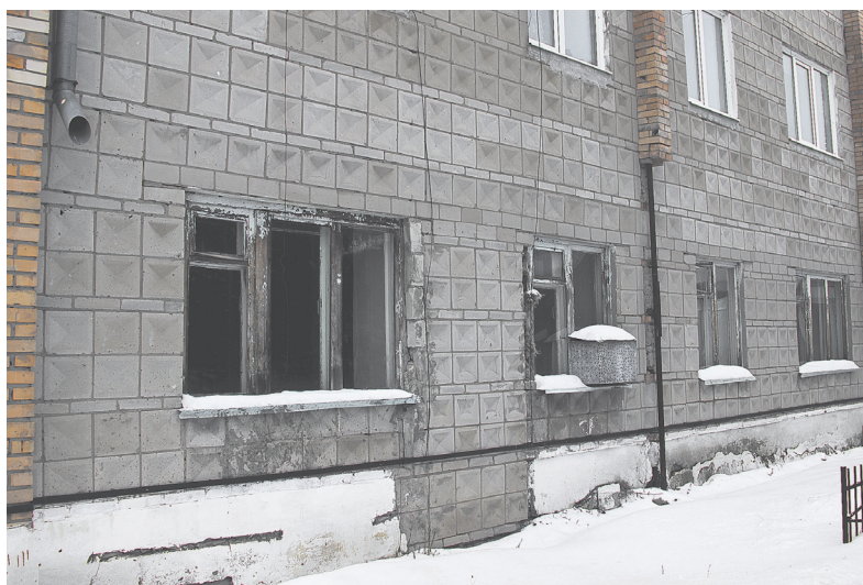
Кое-где стены больницы в Октябрьском подпирают железные трубы
