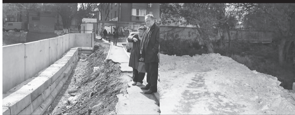
ОБРУШИВШИЙСЯ ТРОТУАР У ДОМА ПО УЛ.СТАВРОПОЛЬСКОЙ, 107/11 МЭРИЯ ВОССТАНАВЛИВАЕТ
