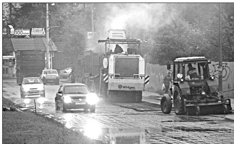
Как видим, откладывая из-за дождя ремонт дороги по улице Соколова-Соколенка городские власти не стали.
